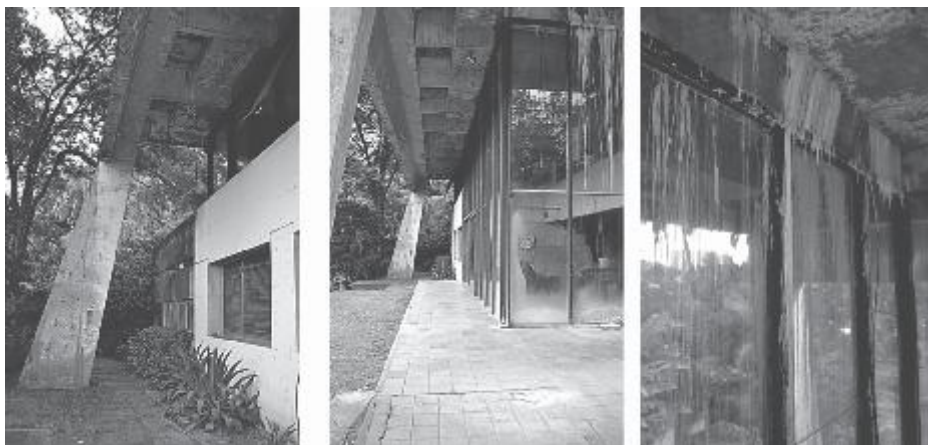
Figura 8: Danos existentes na obra. Fonte: Fotomontagem da autora, 2026.
