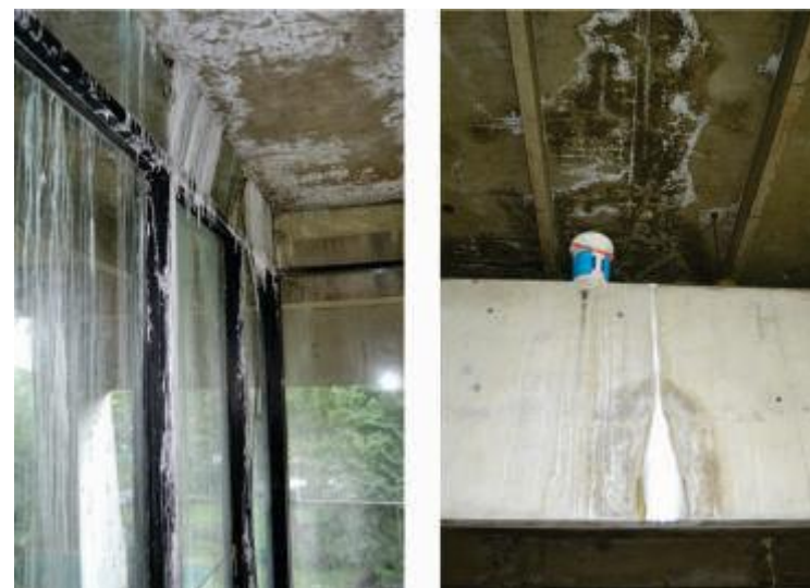
Figura 9: Eflorescências e lixiviação em lajes e vigas de concreto da sala de estar. Fonte: Fotomontagem com imagens realizadas por Afonso. 2025.
