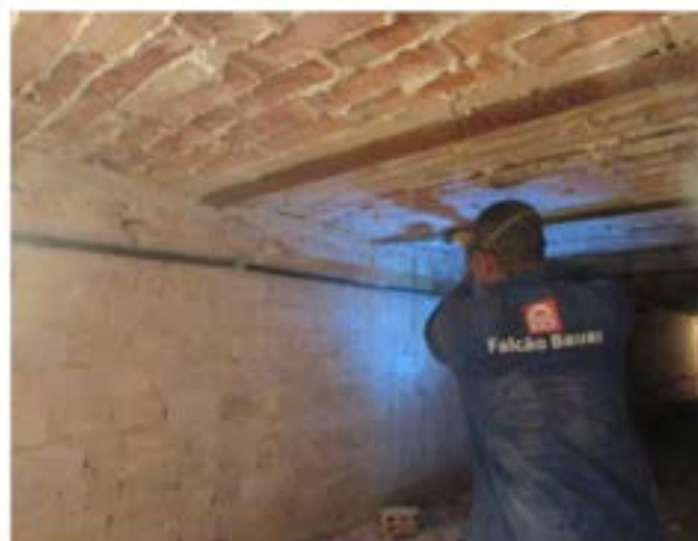
Investigação para verificação em perfis metálicos, com retirada de amostras para análise.
