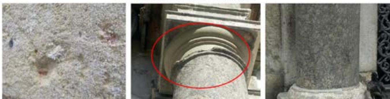
Figura 2: Principais danos encontrados nas fachadas do Paço Imperial : Eflorescência, perdas de massa e crosta negra.
