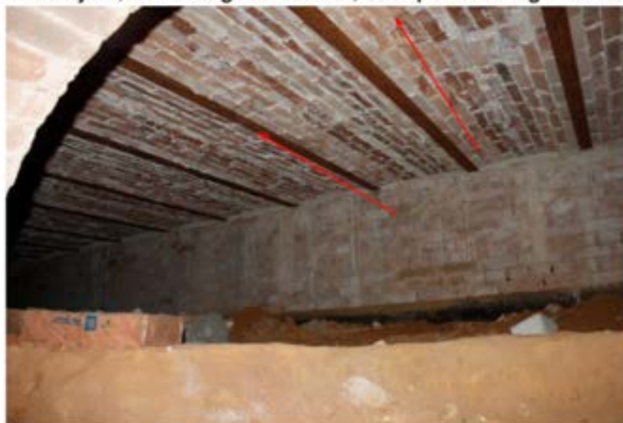
Fig. 5: Abobadilhas de tijolo, sob o saguão central, com parte do vigamento de ferro aparente.
