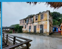
Colapso parcial da cobertura
