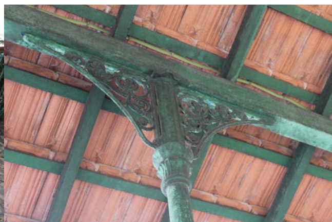
Figura 13. Mão francesa em ferro fundido na coluna do Pavilhão 4. Fonte: Paulo Fraga Silveira, 2018.
