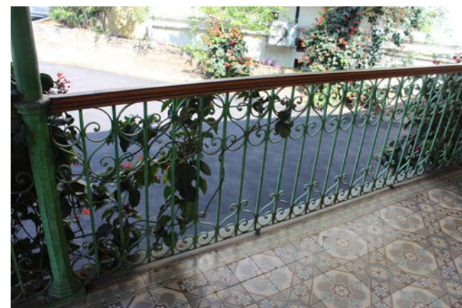
Figura 12. Gradis de ferro da varanda da entrada principal do Pavilhão 4. Fonte: Paulo Fraga Silveira, 2018.
